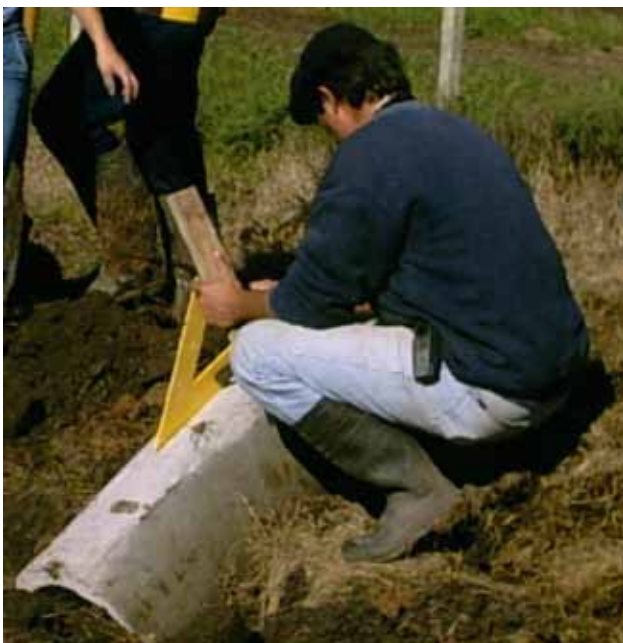
Utilización de escuadra a 45°. Instalación de biodigestor en la Escuela Agraria de Rocha.
