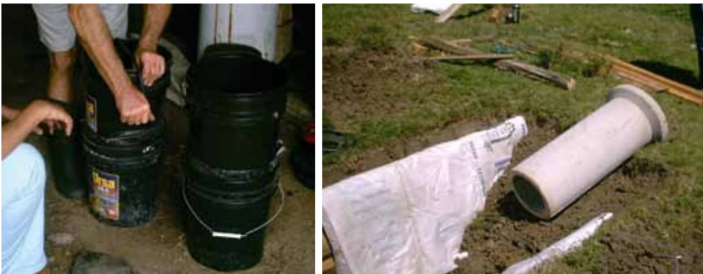
Armado de las bocas del biodigestor. Predios de Miguel Lecchini y Sr Barboza
