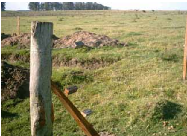
Sitio donde se ubicará el biodigester. Predio del Sr. Barboza. Treinta y Tres.
