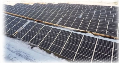
Солнечная электростанция 1.25 МВт Ляховичи, Гродненская область
