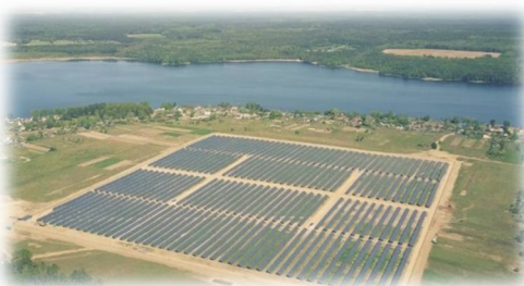
Солнечная электростанция 11.4 МВт Чечевичи, Могилевская область
